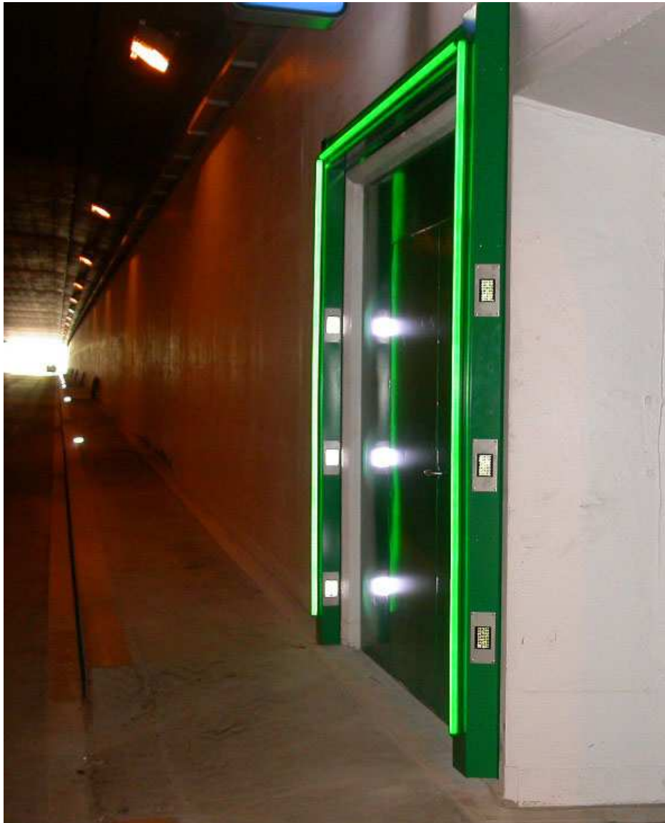
SEÑALIZACION-ILUMINACION SALIDA EMERGENCIA TUNEL
